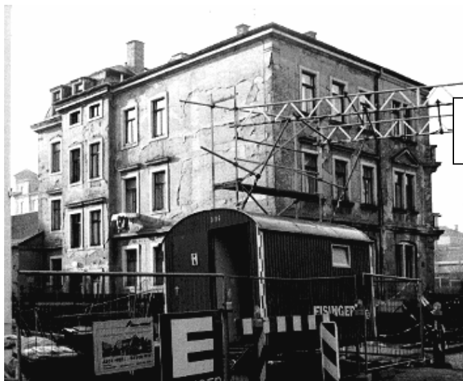
Das Mansarddach ist hier nicht mehr vorhanden (Kriegsschaden)
